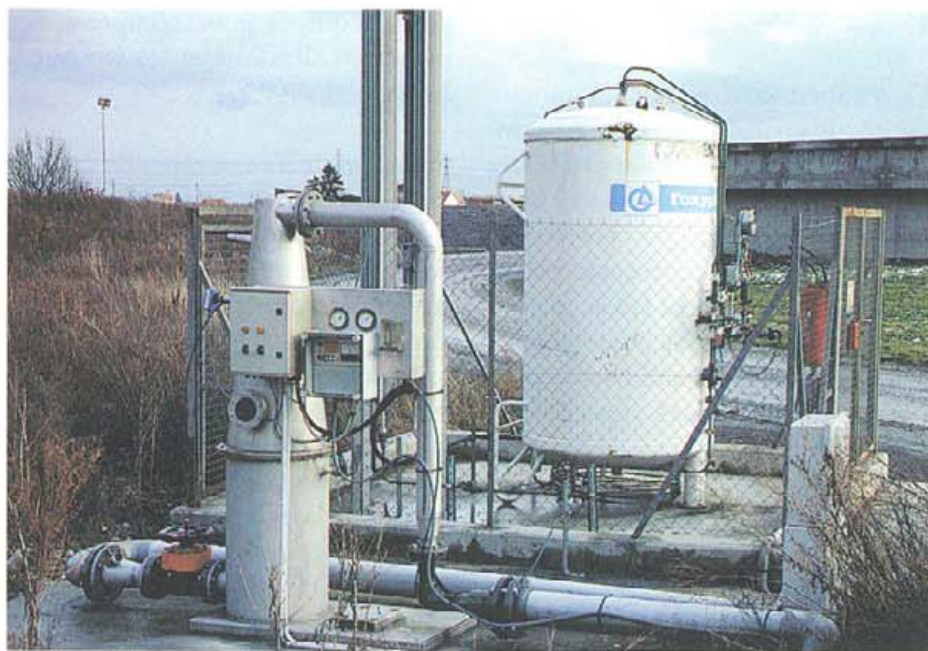
Station fixe d'oxygénation du canal usinier MUHLBACH à COLMAR
