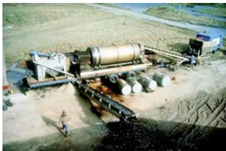
Centrale mobile de lavage des galets ©CEDRE
