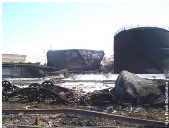
Cuve de stockage de la centrale de Jiyeh suite aux bombardements en juillet 2006 ©LE FLOCH DEPOLLUTION
