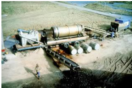
Centrale mobile de lavage des galets ©CEDRE
