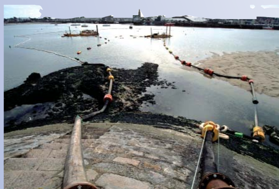
Chantier de pompage de la nappe sous-marine de la passe de Pen Bron
