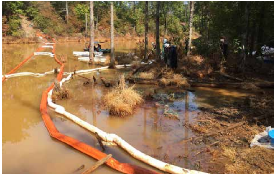
Récupération sur l'eau et protection des berges d'un étang artificiel, suite à la rupture d'un pipeline d'essence (27/9/2016 Pelham, Shelby County, Alabama) (Source : US EPA)
