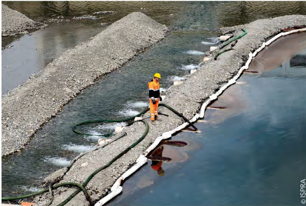
用於過濾漂浮污染物的路堤和傾斜管線。
