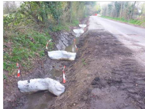
Succession de dispositifs (absorbant 'spaghetti' et grillage) de captage de la pollution résiduelle, le long d'un fossé routier emprunté par la pollution (préalablement purgé et curé) (Source : Cedre)
